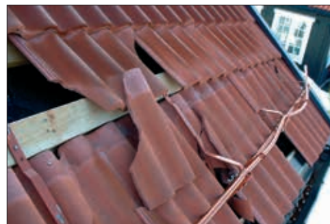
Skadet taktekkning som følge av mangelfull taksikring
