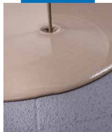
Påføring av Ultraplan selvutjevne avrettingsmasse over tørr Eco Prim Grip på gammel gulv
