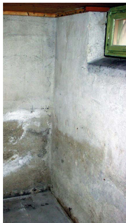
Eksempel på en dårlig drenert og isolert kjellervegg der det har oppstått fukt- og muggskader.
