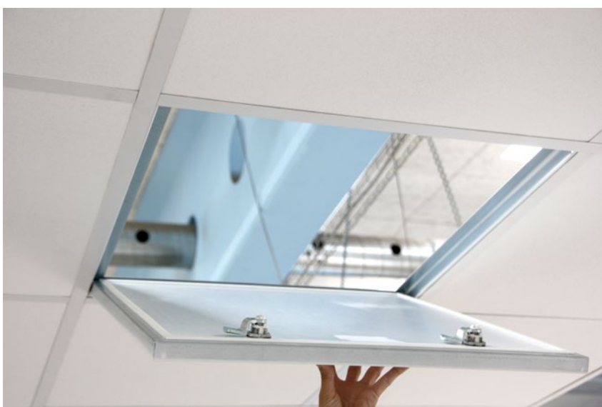
Enkel tilgang til bakenforliggende installasjoner.
