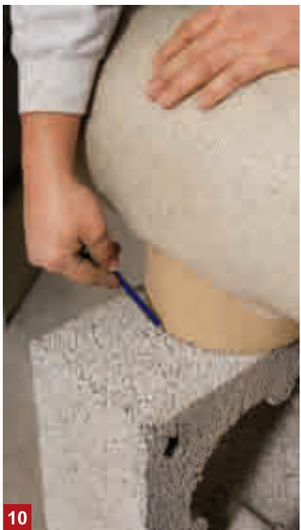
10. Målet fra bilde 9 merkes av fra kanten av et av elementene. I enkelte tilfeller kan det hende det må lages utsparing i 2 stk ytterelementer for røykinnføringen.
