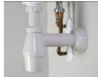
Synlig del av rørsystemet etter montering av 40 mm Smartline frem til vegg.
