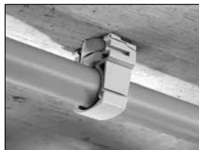
Cable conduits or light duty pipes
