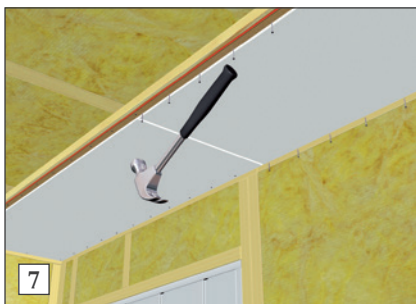
7) Skjøtene skal ikke limes. Spikeravstand er c/c 150 mm. For å unngå skader på platen utføres siste spikerslag med dor. Kramper og skruer kan også benyttes (se mont.veil. M005-08-04).
