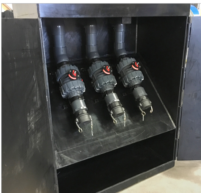
Kjemikalieskap for veggmontering med ventiler og rør av PVC
