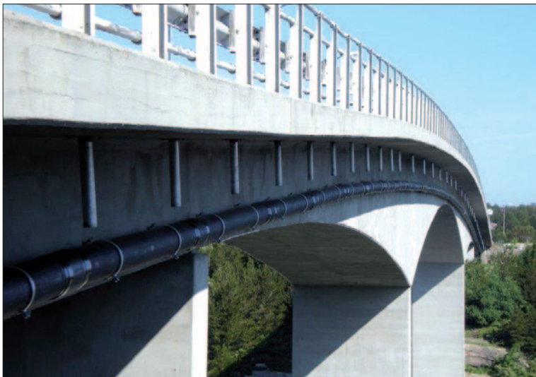
Ulvesund i Øygarden med Isovarm rørledning
