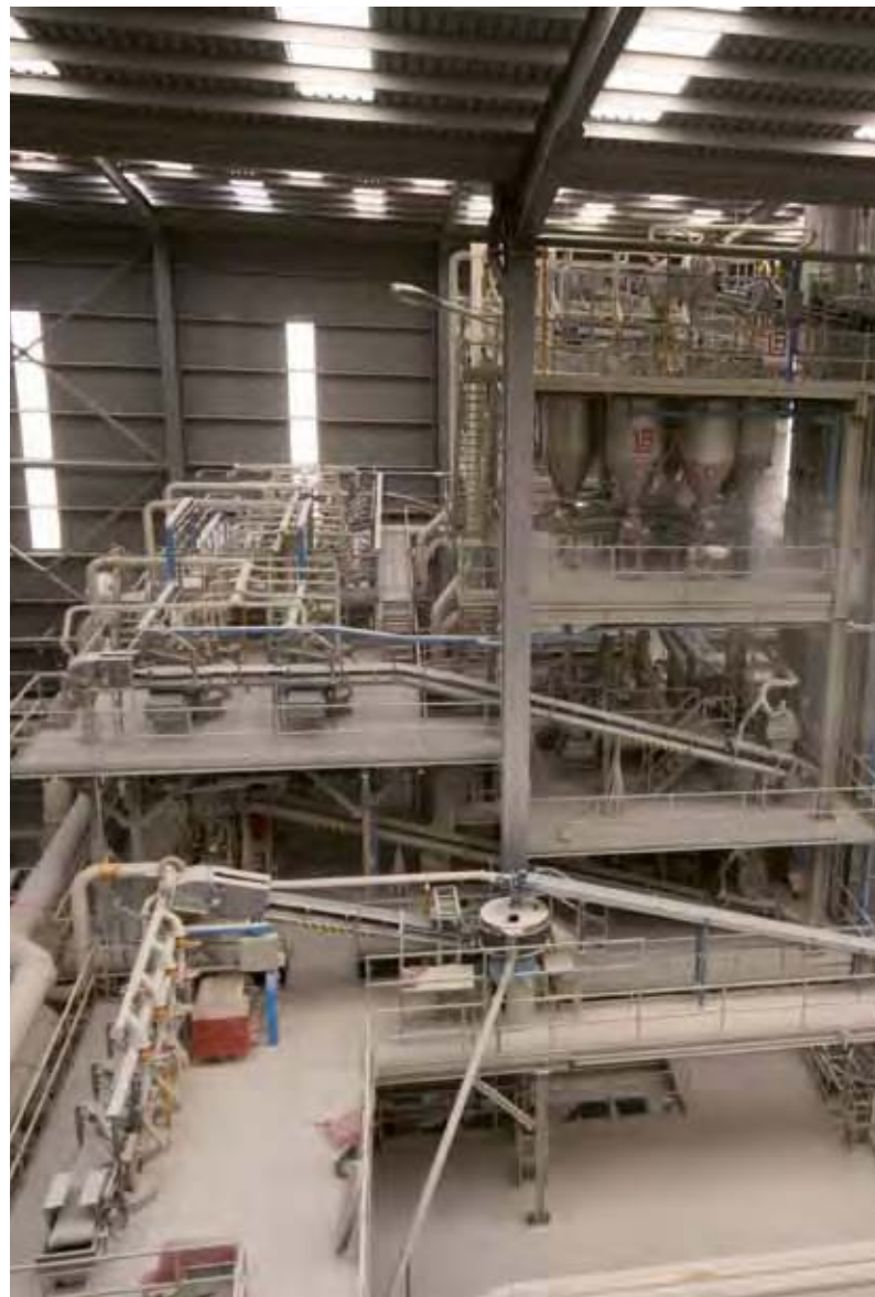
Silostasjon for blanding av leiremasse og farger
