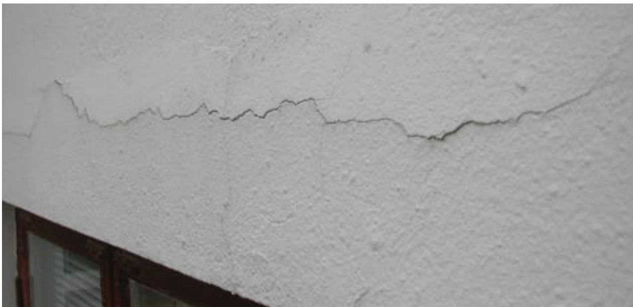
Eksempel på sprekk i puss pga. rustangrep på innmurt stålbejke over vindu.
