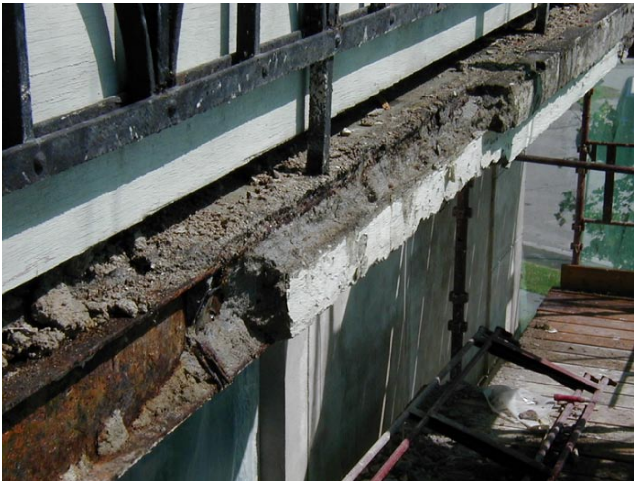
Korroderte bærebjelker i balkonggulv.
