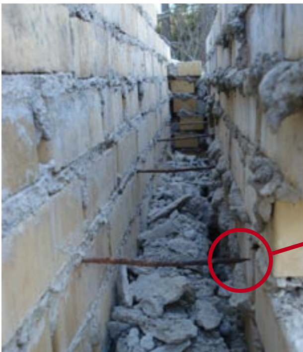
Ved åpning av vegg ble det stedvis registrert at binderne var helt avrustet på innvendig side av ytre vange til høyre. Dette er et område som er spesielt fuktutsatt fordi drivregn og nedbør som trenger igjennom teglvangen vil renne nedover på innsiden og derved forårsake korrosjon på bindere som ikke er korrosjonsbestandige.
