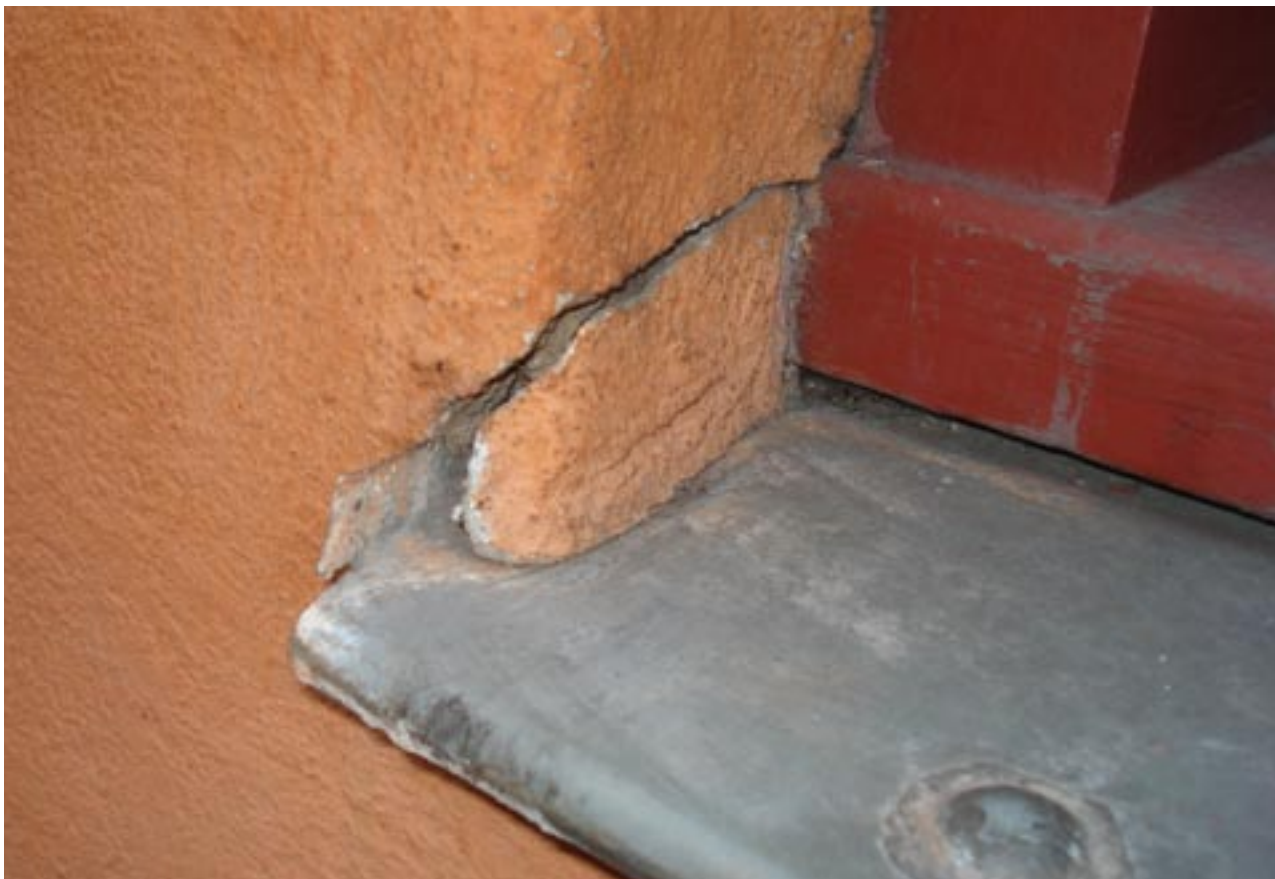
Innpusset sinkbeslag med løsrevet puss
