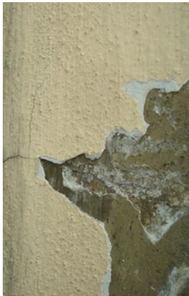
Det kan være vanskelig å avgjøre om underlaget er tilstrekkelig rengjort. Ny finpuss utenpå dårlig rengjort malingsflate fungerte ikke i dette tilfelle.
