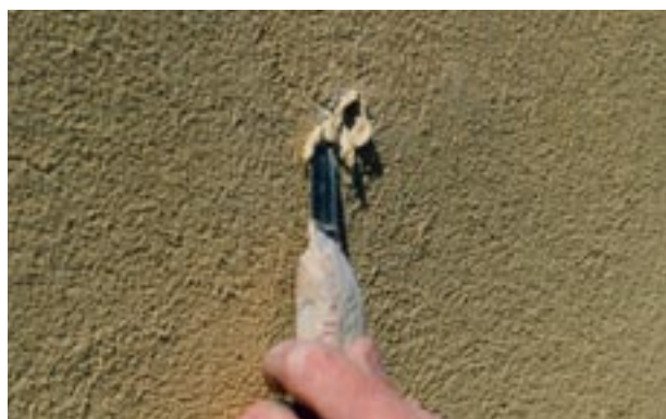
Overflaten dekkes med en slurry basert på en blanding av finpusmørtel og maling.
