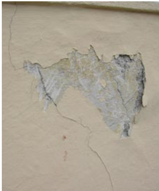
Sprekker i puss synes godt og gir avskallinger på tette malinger.
