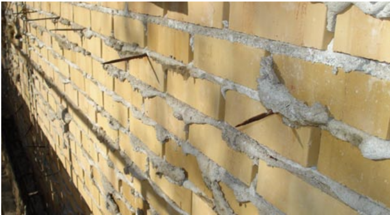
På dette prosjektet ble yttervangen plukket ned som følge av frostskaadet teglstein. Bildet viser at samtlige Z-bindere i en rad var rustet helt av eller var så dårlige at de knakk i forbindelse med riving av ytre vange. Nye korrosjonsbestandige bindere ble her montert fast i bakveggen ved hjelp av slaganker og bøyd til Z-form på vanlig måte etter hvert som oppmuringen av yttervangen skred fremover.
