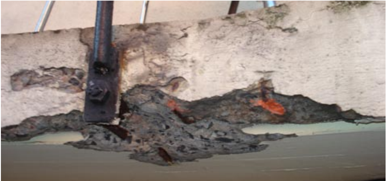
Korrodert armering i utkraget balkonggulv.
