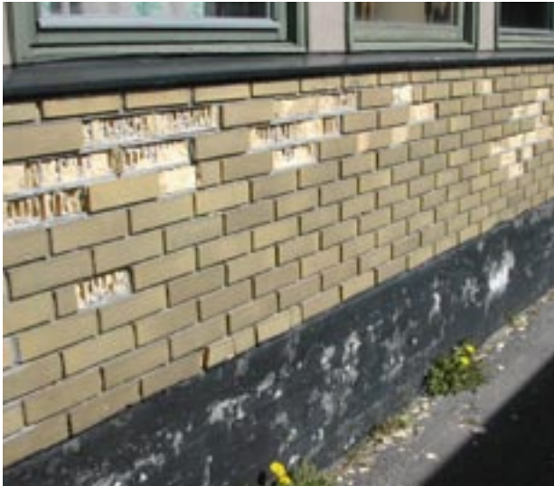
Eksempel på et brystningsbånd med frostskaadet teglstein.
