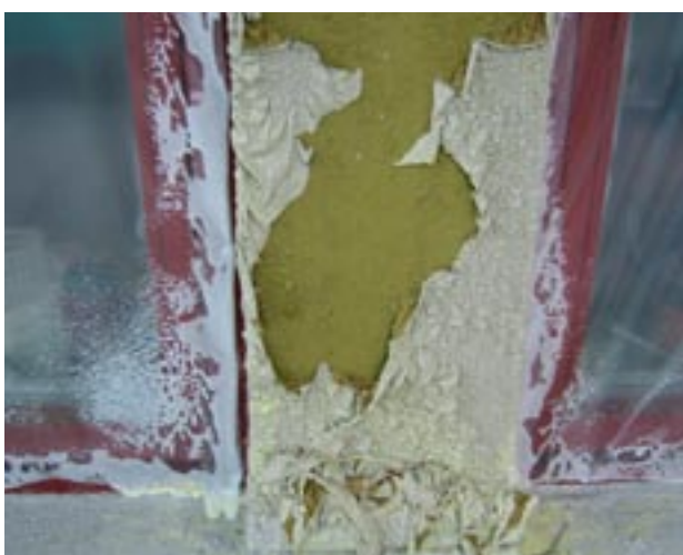
Effekten av rensestoffet gjør at eksisterende maling krøller seg. Kilde: Murkatalogen P6: 2003.
