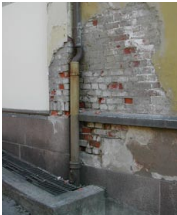
Skader i puss som følge av lekkasje i nedløpsrør blir ofte lokalt begrenset, men betydelige.
