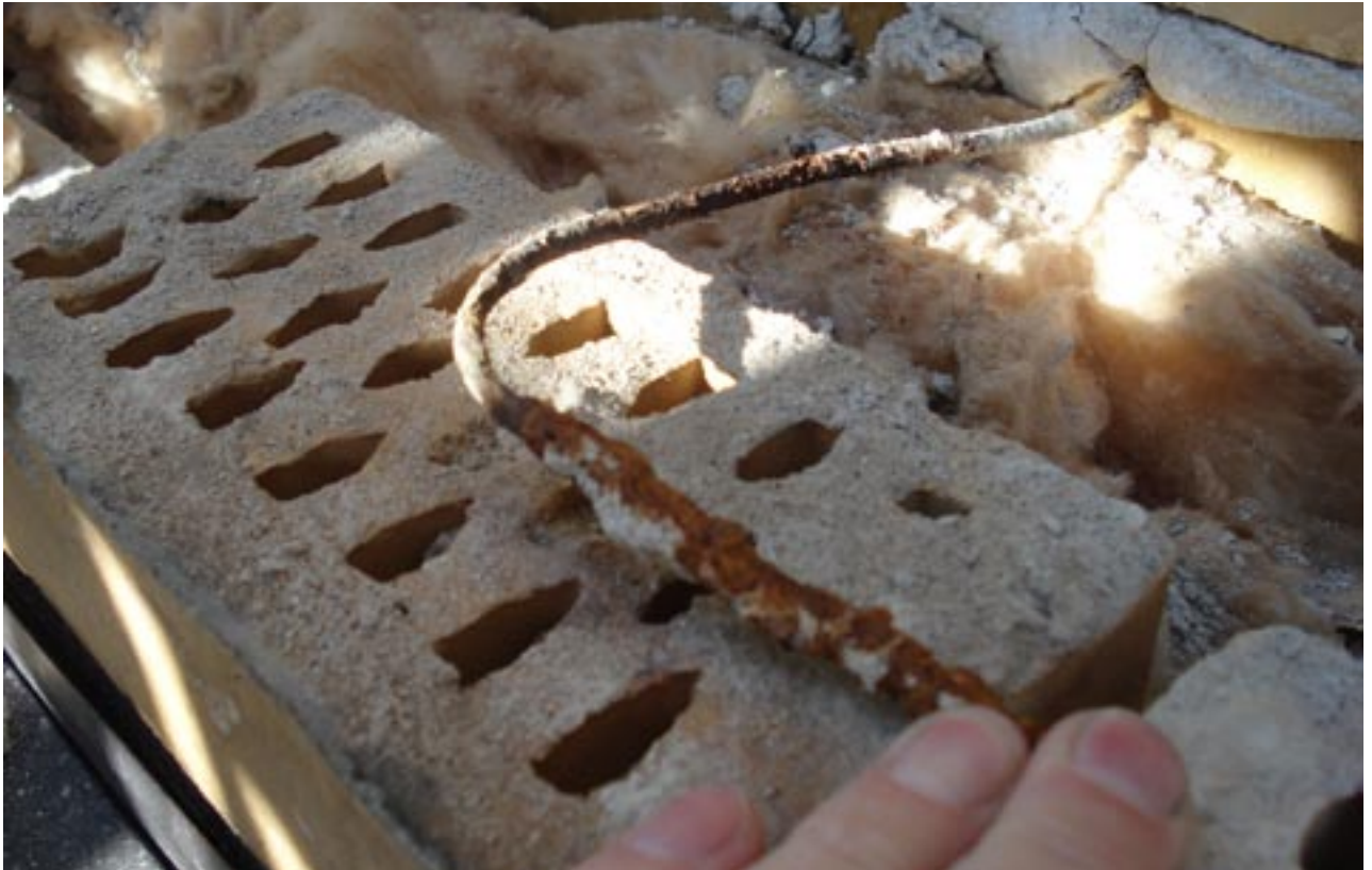
Bildet viser hvordan ytre del av Z-binderen har "ekspandert" som følge av korrosjon. Dette kan da medføre riss i liggefugemørtelen og utpressing av ytre del av løs fugemørtel.
