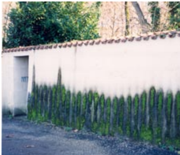
Eksempel på organisk begroing som følge av manglende dryppkant fra taksteinsbelagt murkroner.
