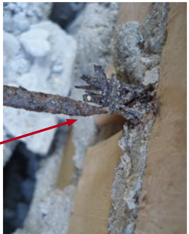
Her sees at korrosjonen har ført til en oppsplintring av binderen rett på innsiden av yttervange.
