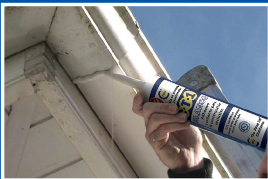
Reparerer umiddelbart takrenner som lekker
