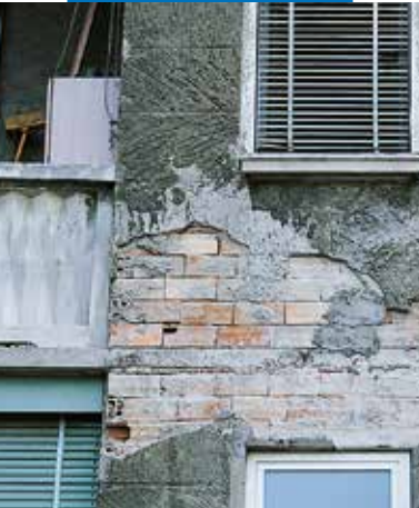
Nedbrutt fasade som trenger reparasjon
