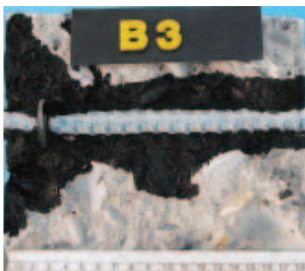
Dannelse av svinnsprekker skaper fare for sivevann ved staggjennomføringer.
