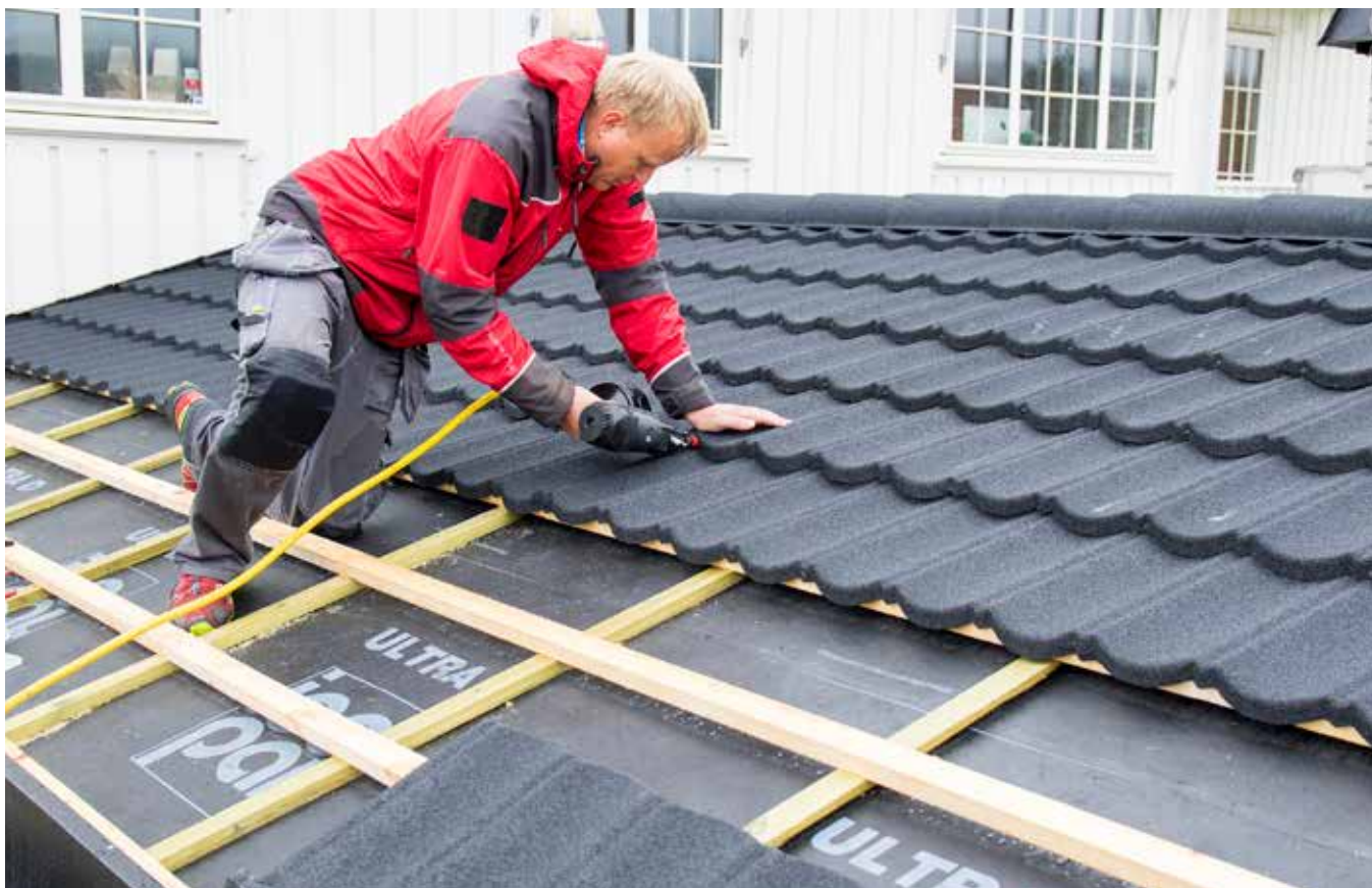
Montering av AeroDek Tradition Plus på bærende undertak, tekket med Icopal Ultra D underlagsbelegg
